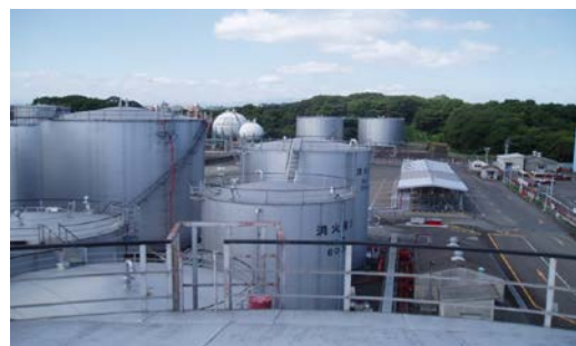
出光興産 貞山塩釜油槽所
