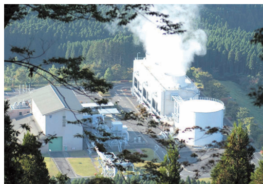
出光と九州電力が共同で運営している滝上発電所
